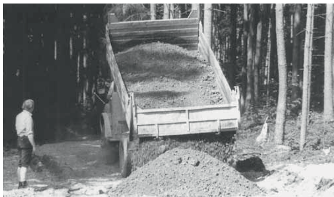
Der Forstwegebau war ein Arbeitsschwerpunkt in den ersten drei Jahrzehnten der WBV Landau.
